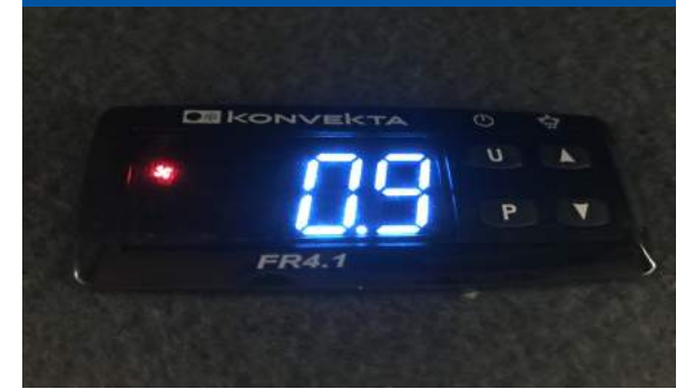
De installatie wordt vanuit de cabine bediend
